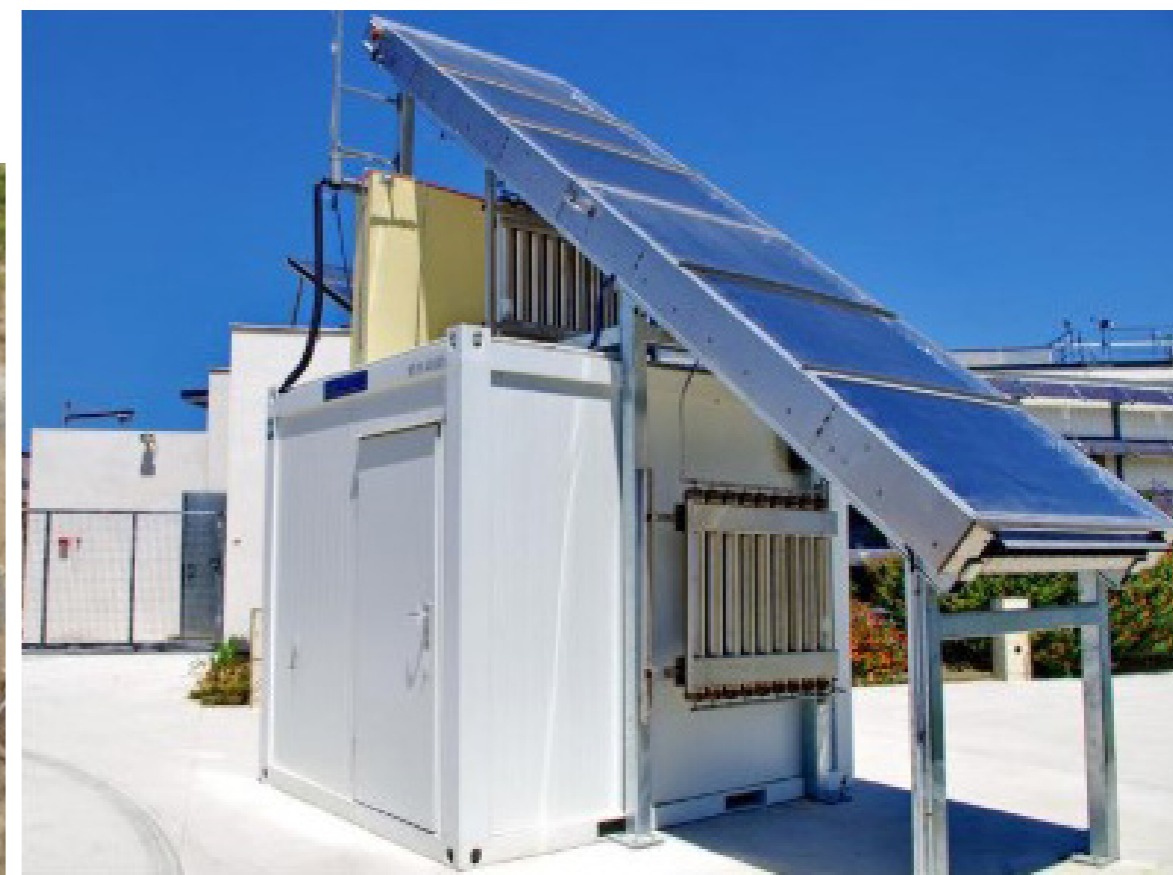
Refroidissement : Modèle d'installation d'enceinte frigorifique, relié à un onduleur et alimentée par des panneaux solaires
